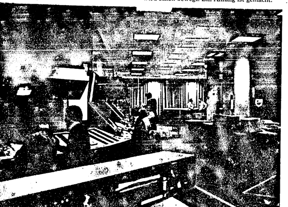
So sieht es in einem Raum der Flugsicherung aus. Mit modernsten elektronischen Geräten wird dafür gesorgt, daß für den Flugverkehr „die Luft rein ist“.
